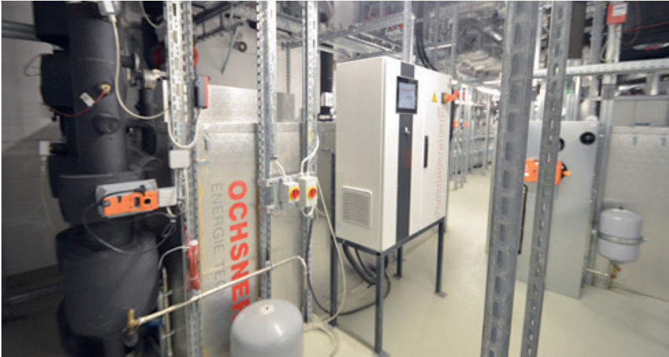
Wärmepumpen im Untergeschoss des Humboldt Forums
