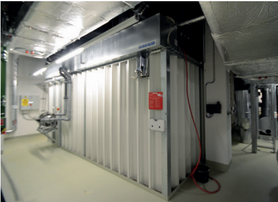
Eisspeicher im Untergeschoss des Humboldt Forums
