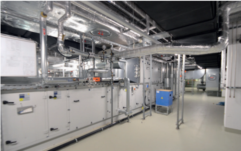
Vollklimaanlage im Untergeschoss des Humboldt Forums
