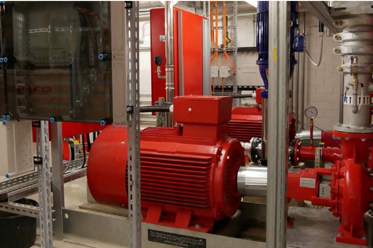
Einblicke hinter die Fassade: Anlagen auf dem Dach und Technikräume
